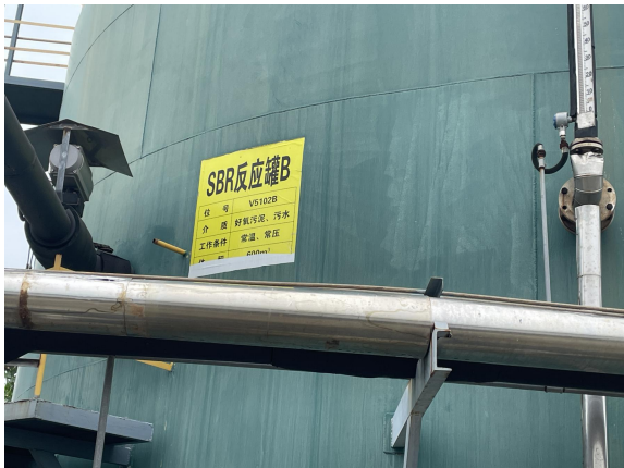
SBR 反应罐 B
