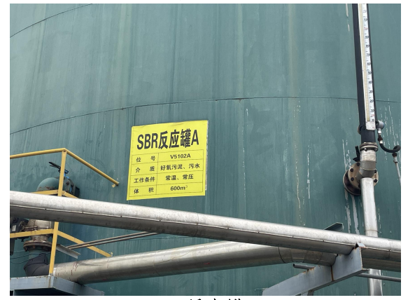
SBR 反应罐 A
