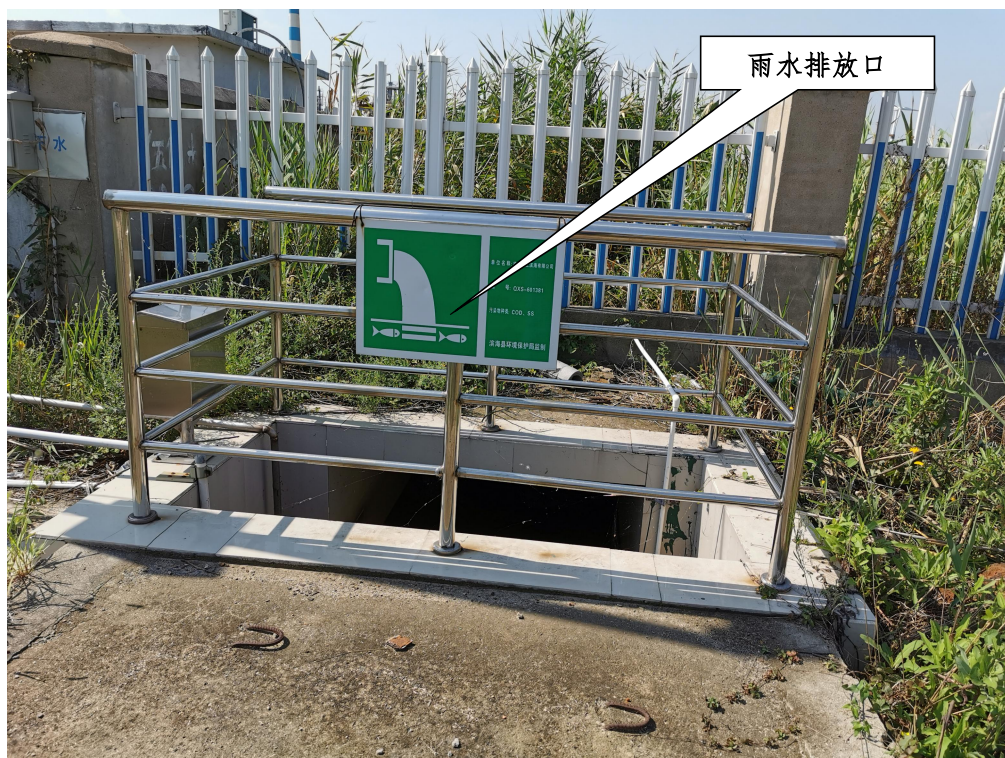
图 4.2-1 雨水排放口及污水排放口设置情况
