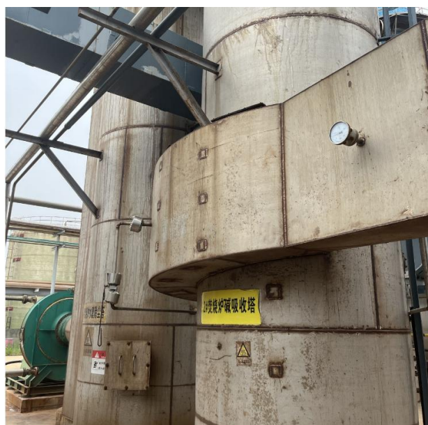
一级碱吸收+一级水膜除尘（后处理）
