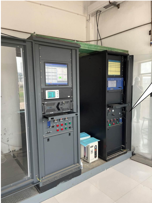
废气在线监测（颗粒物、SO 2 、NO x 、CO、氯化氢、非甲烷总烃）
