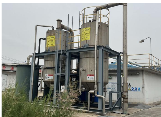
一级碱吸收+生物除臭（预处理）
