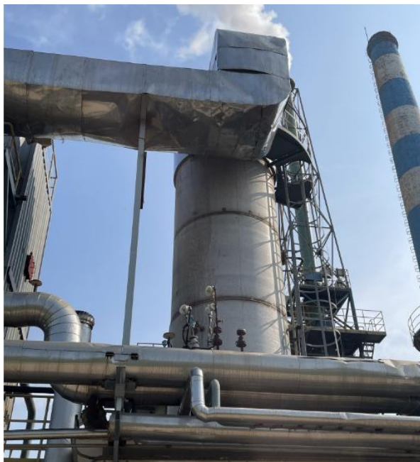
焚烧尾气急冷装置
