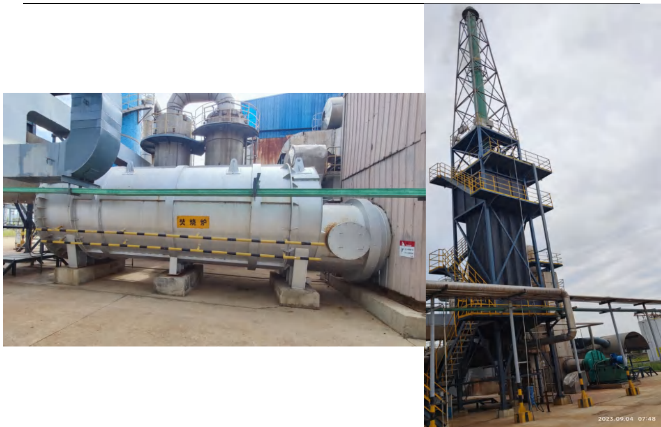
图 3.3-5 危废焚烧炉照片
