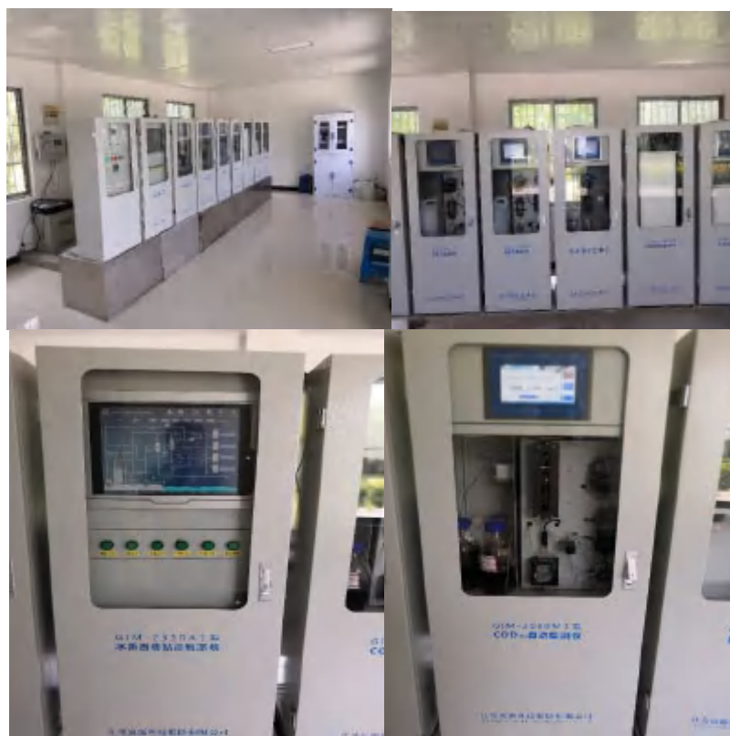
图 2.5-8 地表水自动监测站现场照片
