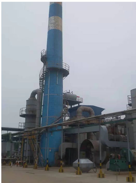
图 3.3-4 危废焚烧炉照片
