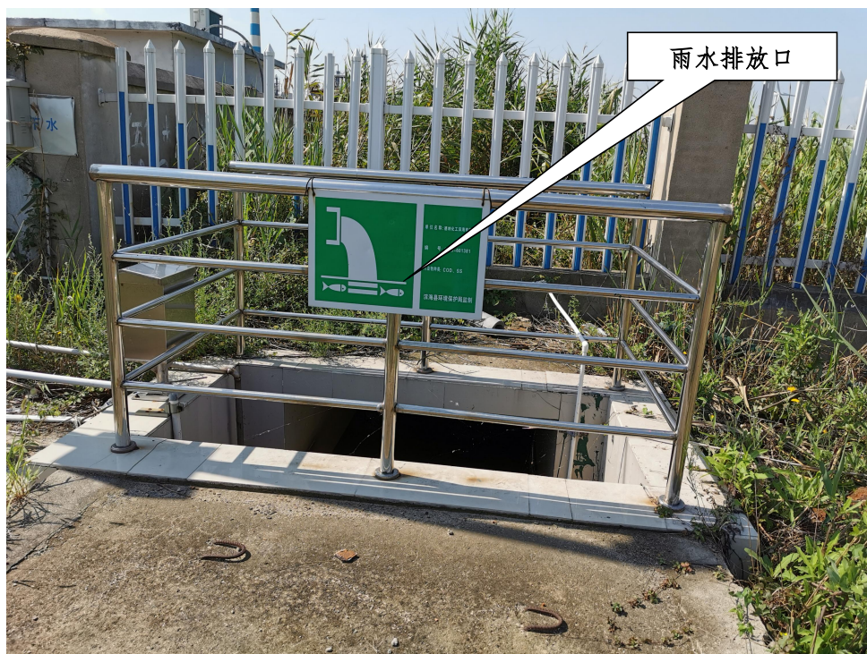
图 4.2-1 雨水排放口及污水排放口设置情况
