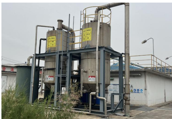
一级碱吸收+生物除臭（预处理）
