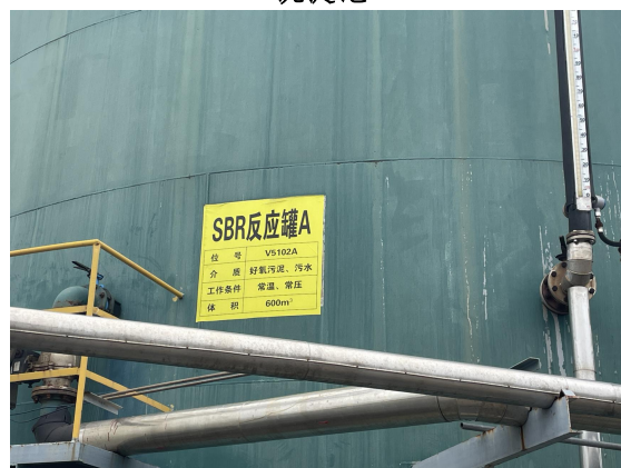
SBR 反应罐 A
