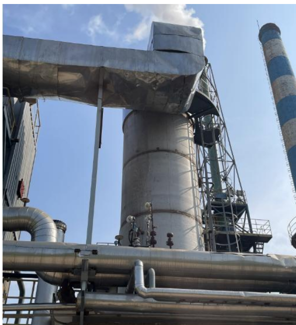
焚烧尾气急冷装置
