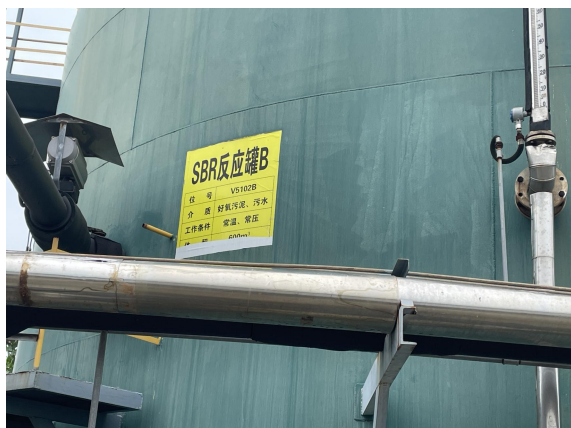
SBR 反应罐 B
