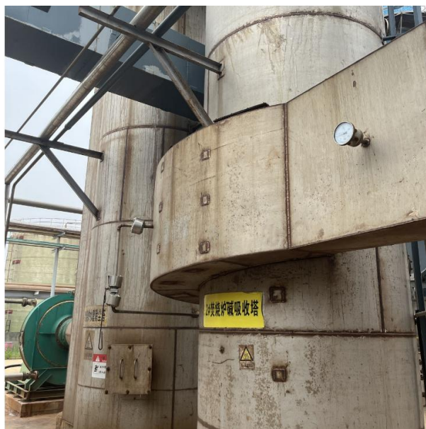
一级碱吸收+一级水膜除尘（后处理）
